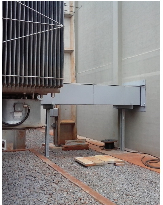
ABB – ADEQUAÇÃO CAUÊ 13,8kV – 4000A
