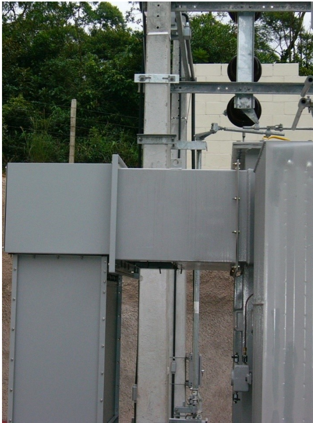
BIOGÁS – UTE SÃO JOÃO 4,76kV – 2500A
