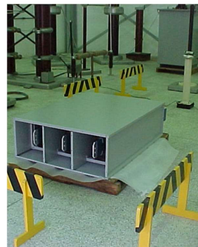
VOITH SIEMENS Hydro UHE GUAPORÉ 3x50MVA 15kV-2500 A SPB Ensaio de tipo
