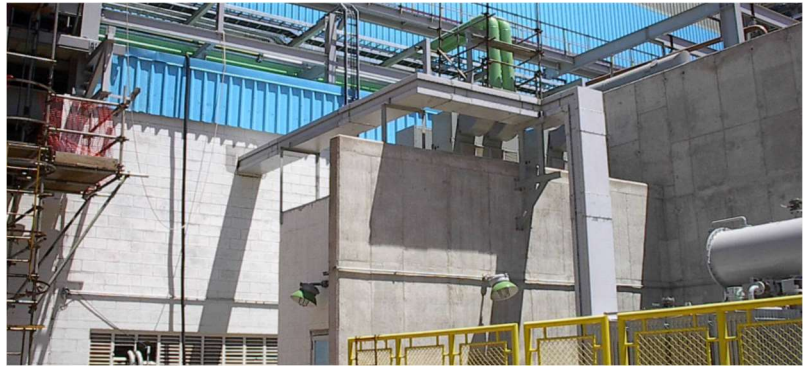
ANDRADE GUTIERREZ - CST UTT TUBARÃO TG 5-6 Barramentos B.O.P 480V-5000 A
