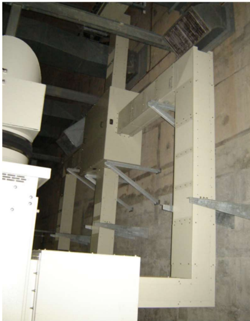
ANDRADE GUTIERREZ - CST UTT TUBARÃO TG 5-6 Barramentos B.O.P 480V-5000A
