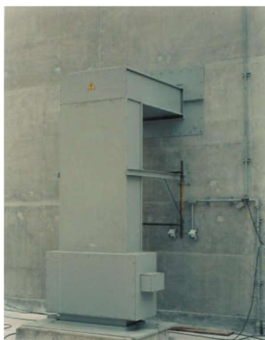
VOITH SIEMENS Hydro UHE GUAPORÉ 3x50MVA 15kV-2500 A SPB
