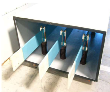
IESA - GE Hydro/ESCELSA UHE MASCARENHAS Unid. 4 (55MVA) 13,8kV-2500 A NSPB
